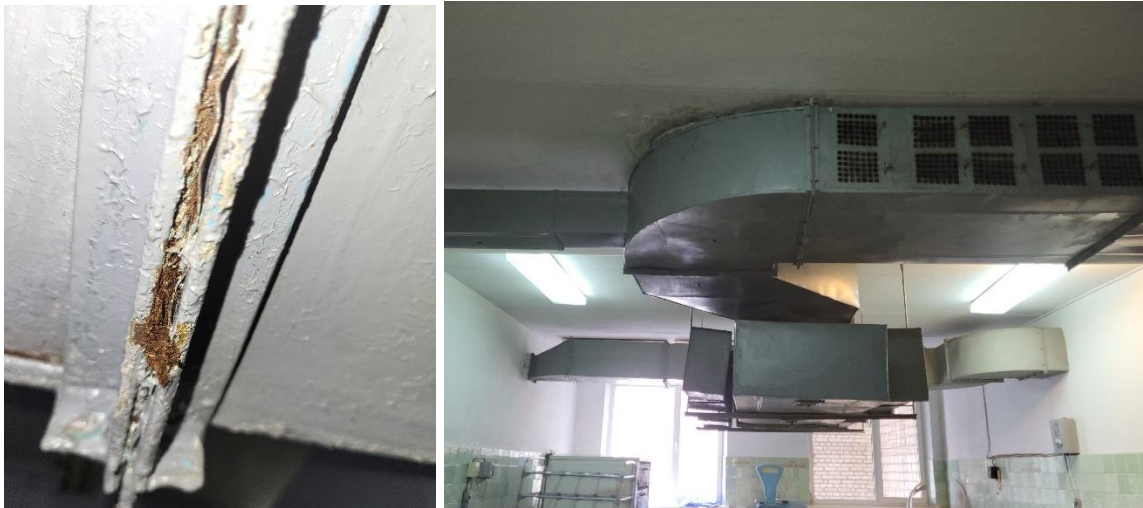
Рис. 2 – Місце розташування підозрілого матеріалу – шнур на вентиляційному каналі
